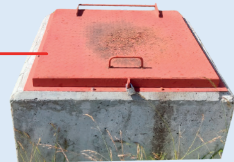
CÁMARA PILÓN DE INCENDIO
